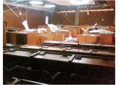
▲天井が崩れた市役所5階の議場
